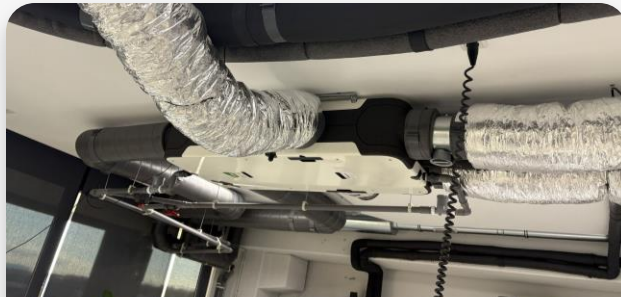
Dimensionado de conductos
